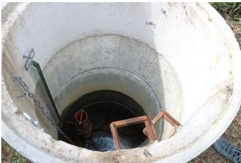
© Zo ziet de "Drain Control Schacht" er van binnen uit.
